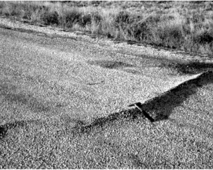
Şekil 8. Deprem nedeniyle asfalt yolda meydana gelen deformasyon.
