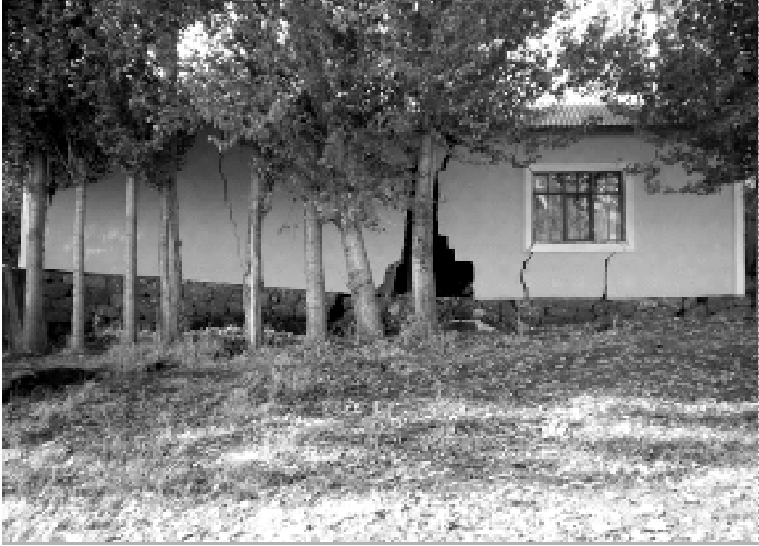
Şekil 3. Sıvılaşmaya bağlı yanal yayılma dolayısıyla zarar gören ev.
